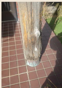
傷んだポーチ柱
